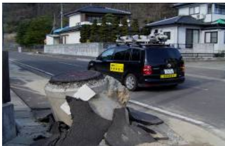
図2 液状化に伴う地盤沈下とマンホール
